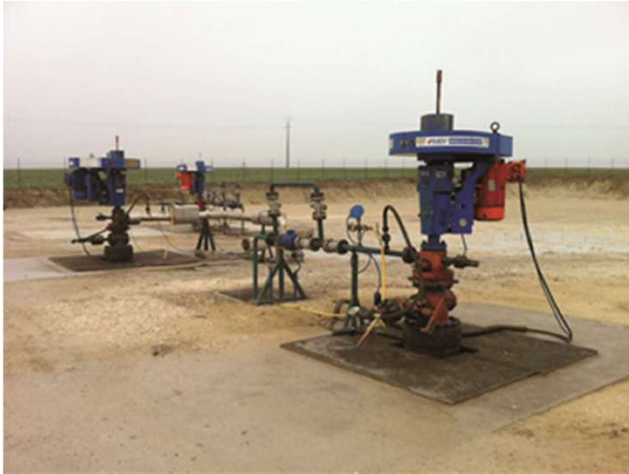
Figure 2: Photographie illustrant les installations de surface des pompes à cavitation progressive (crédit Rival studio pour SPPE)
