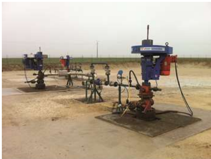
Figure 4 : Photographie illustrant les installations de surface des pompes à cavitation progressive (photo : Rival studio, pour SPPE)
