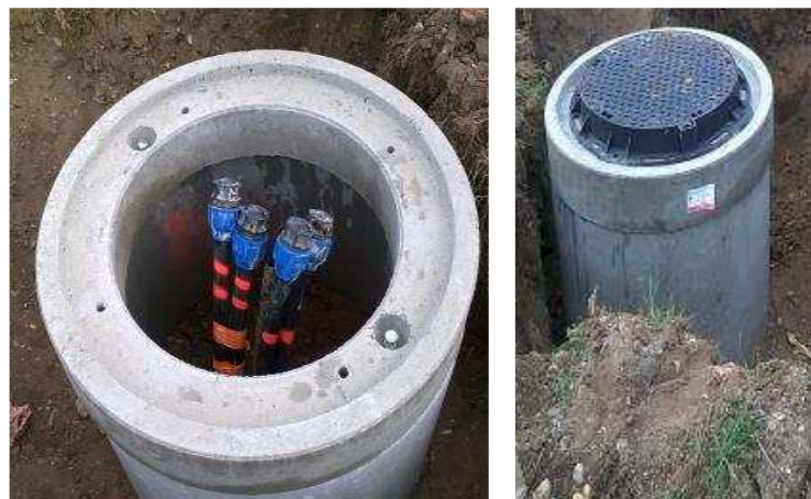
Figure 12 Exemple d'un chantier de forage de gradient réalisé et pérennisé en surface
