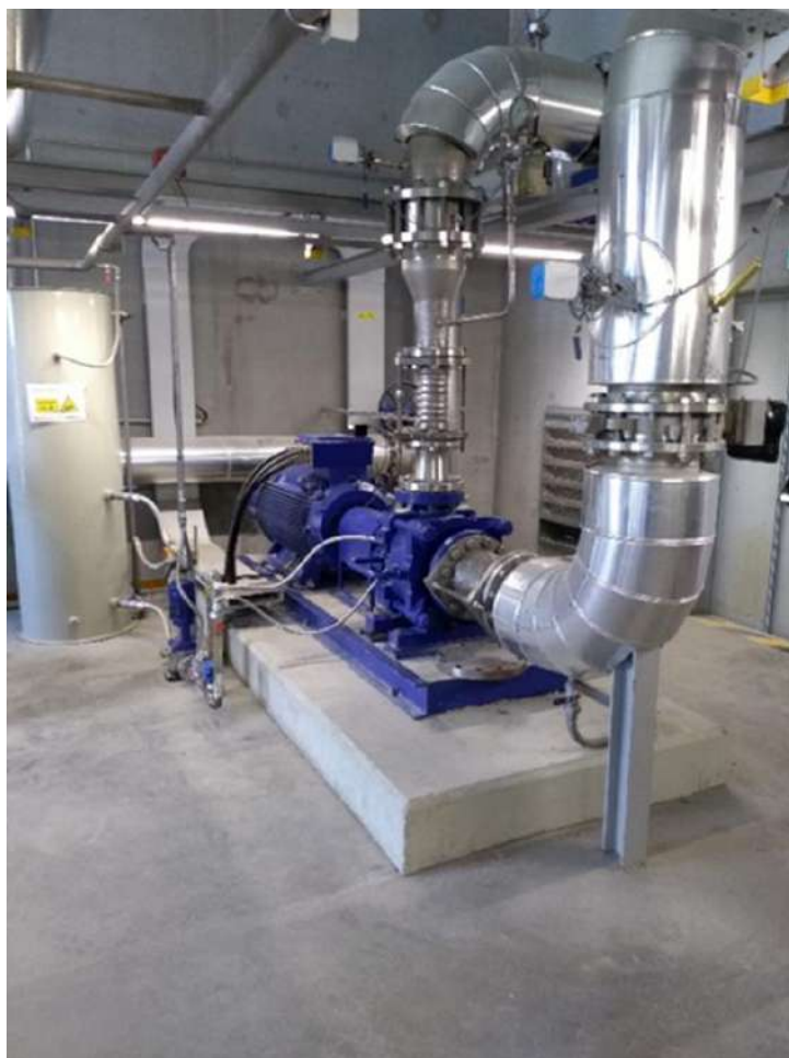
Exemple de pompe de réinjection
